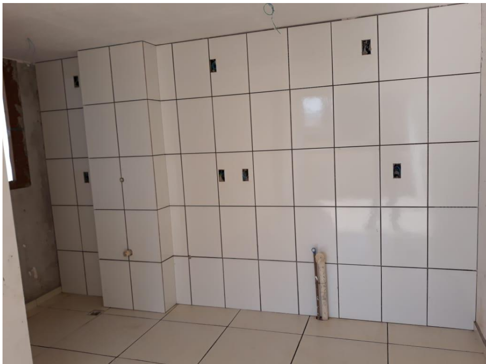
Figura 21: Revestimento cerâmico interno na parede cozinha.
